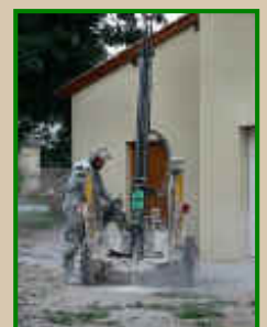
Près des bâtiments
