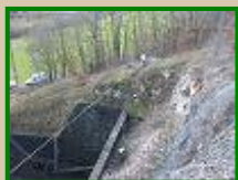
Evacuation de la chambre d'éboulis
