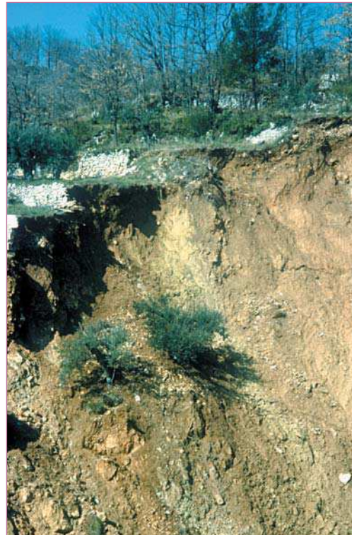
▶▶ FIGURE 8 - Effondrement de cavité naturelle dans le gypse du Trias provençal.
